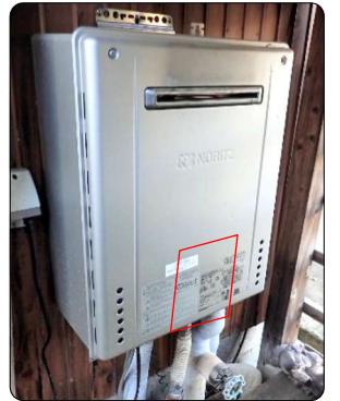
我が家の給湯機 赤枠内に機器の仕様が表示されたシールが貼付
