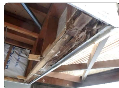
軒裏下地材はすっかり腐食
