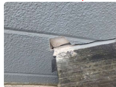
赤丸内：捨て谷先端に、雨水を外へ逃がすための折り返しが無いため、ここから外壁内に雨水が侵入。
